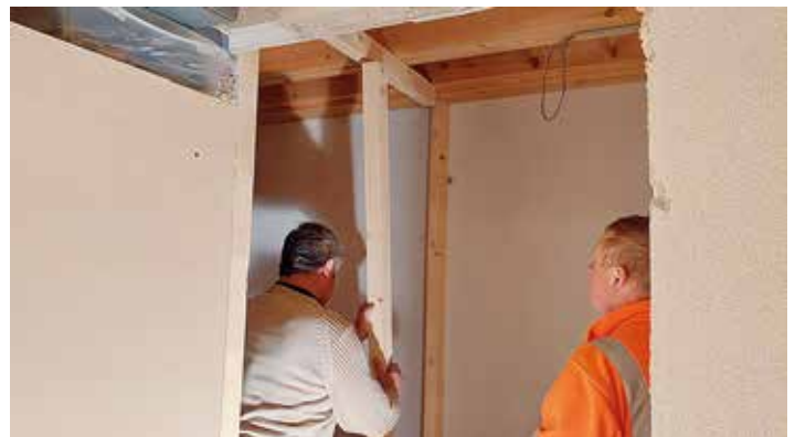
Mit Eifer und voller Erwartung sind die Umbauarbeiten im Bestand der Feuerwehrrhalle angelaufen.
